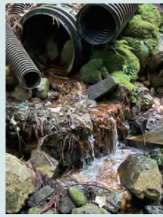
盛土の下から流れる水
