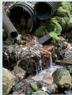
盛土の下から流れる水
