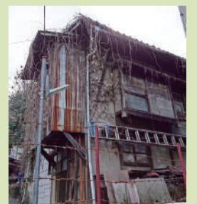
危険な老朽空き家
